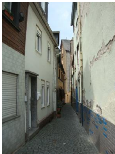
marode Bausubstanz Löhrgasse
